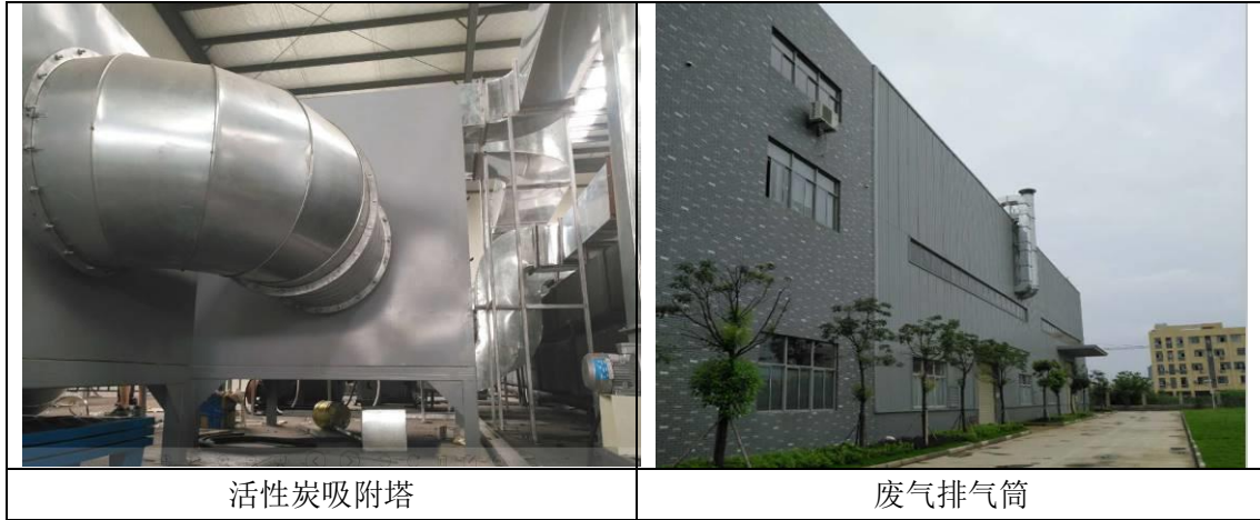
3.8-1 废气处理设施
