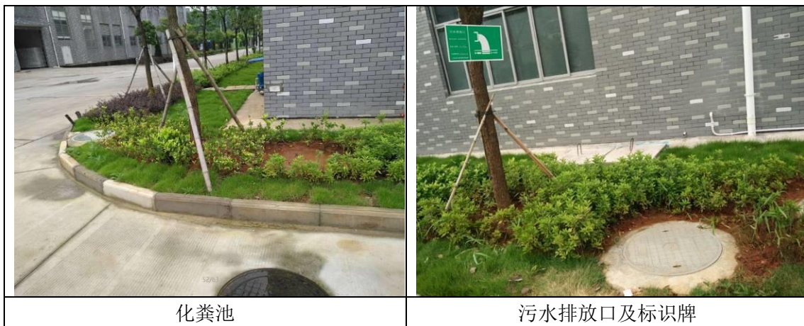
3.8-2 生活污水处理设施
